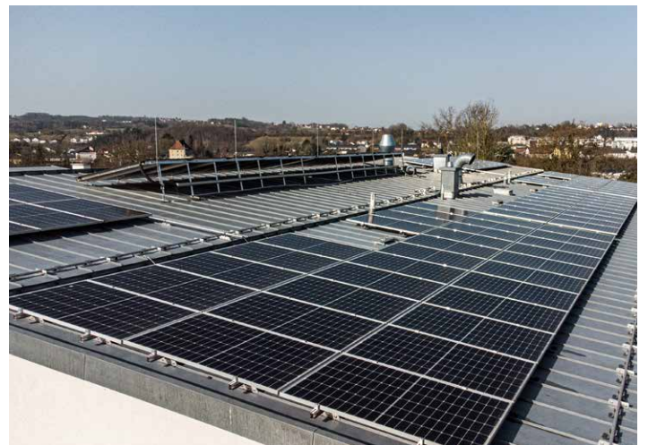
CCE Photovoltaikanlage Grabenhoferweg
