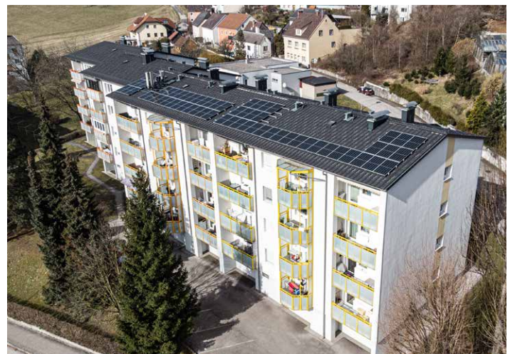
CCE Photovoltaikanlage Kegelprrielstraße
