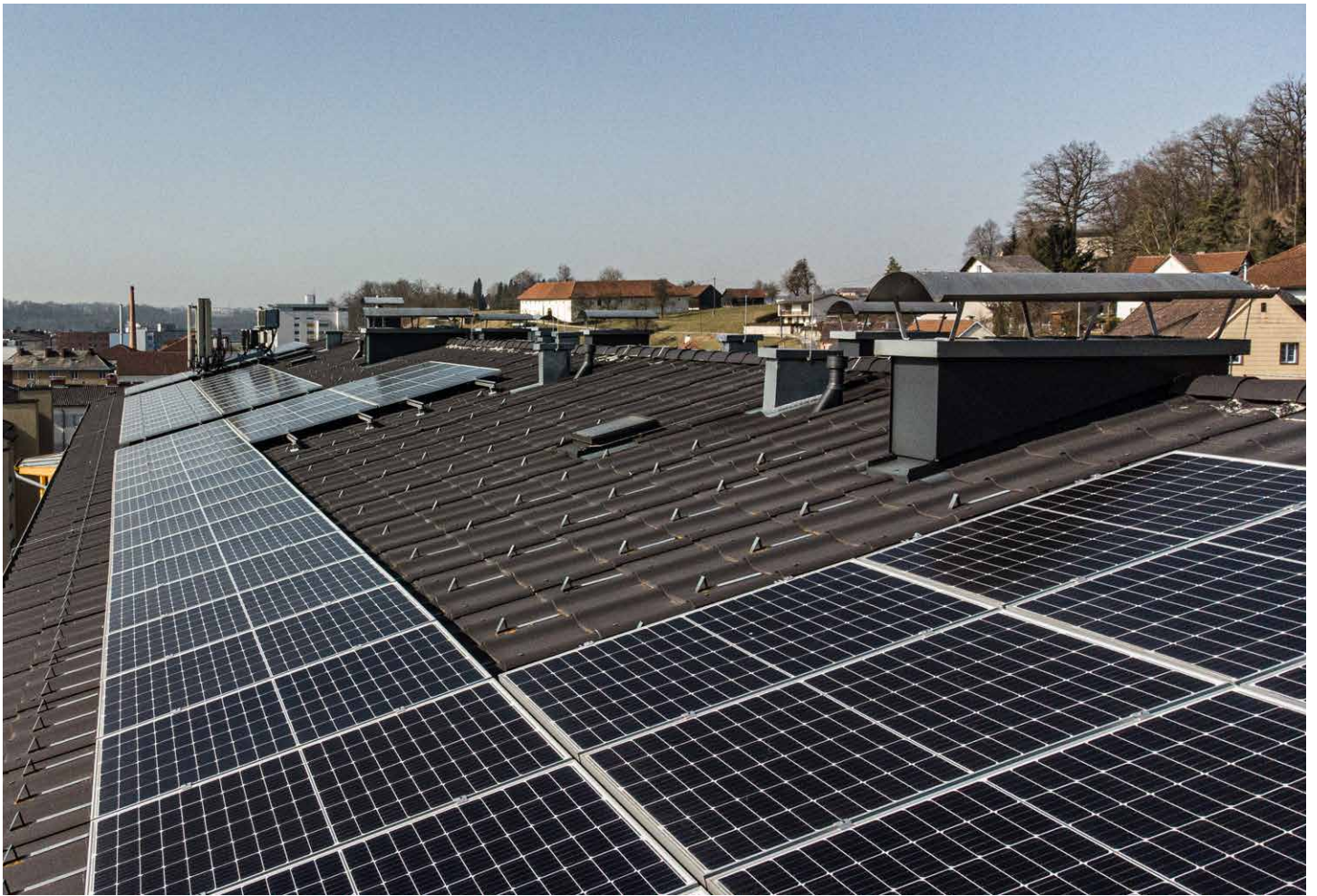
CCE Photovoltaikanlage Kegelprielstraße
